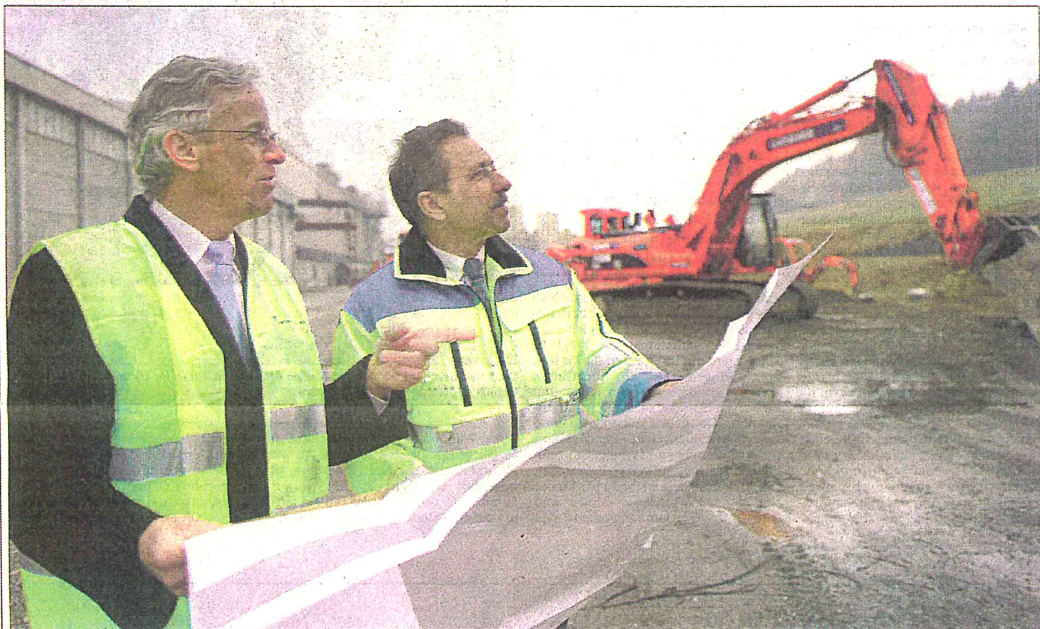
Spatenstich fürs Riesenprojekt: Regierungsrat Max Pfister (links) und Franz-Josef Albrecht, Verwaltungsratspräsident der Chemie und Papier Holding AG.
